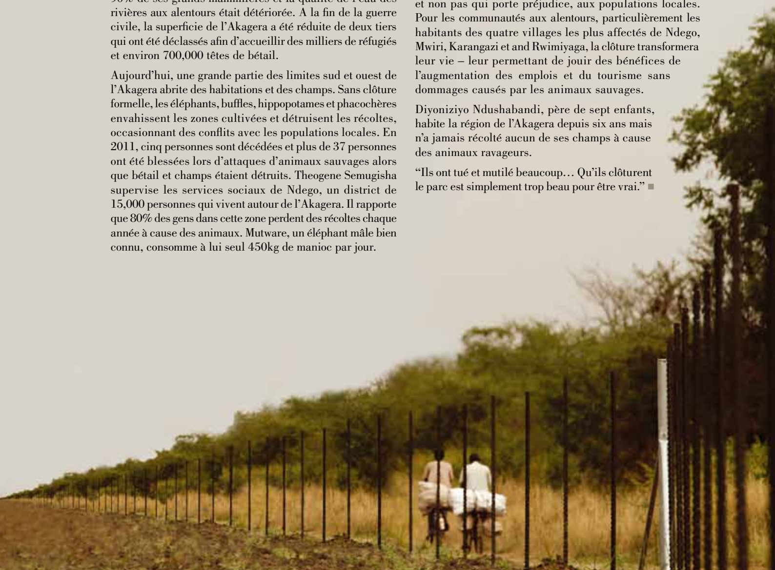
La construction de la clôture a commencé à la fin de l'année sur la limite ouest – Sarah Hall
